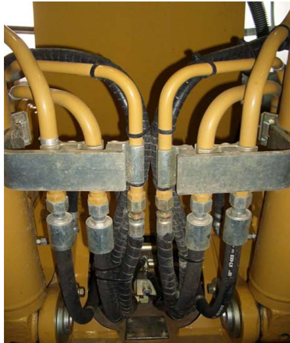
Bild 2: Leckagefreie ältere Hydraulikausrüstung
