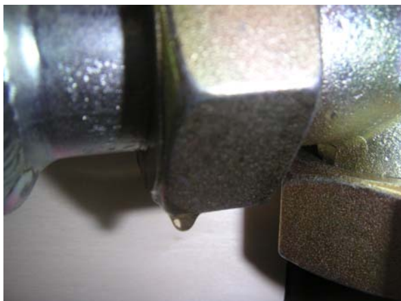
Bild 3: Leckage an einer Verschraubung
